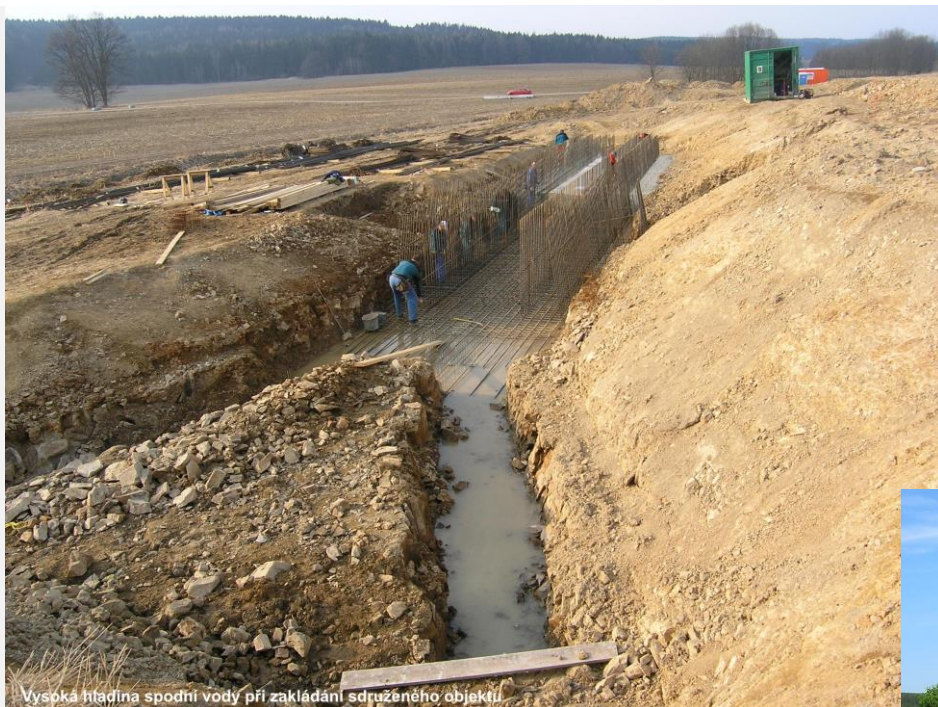
Vysoká hladina spodní vody při zakládání sdrúženého objektu
